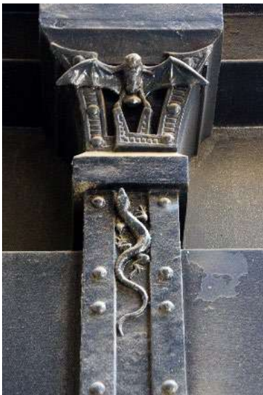
Imatge 29b. Detall de ferro al descobert en la façana de l'edifici (Tono Giménez)
